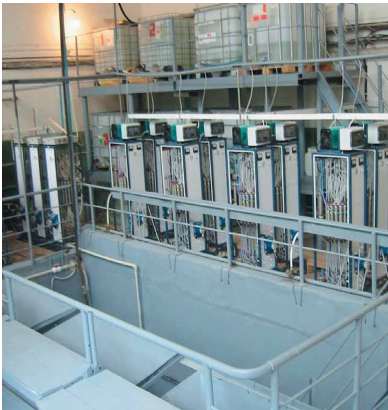
Рис. 4 19 установок АКВАХЛОР-500 на водоочистой станции г. Балаково, 2008.
